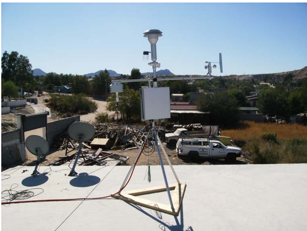
Foto 2. Sitio 17, Monitor instalado en azotea de Ferretería.
