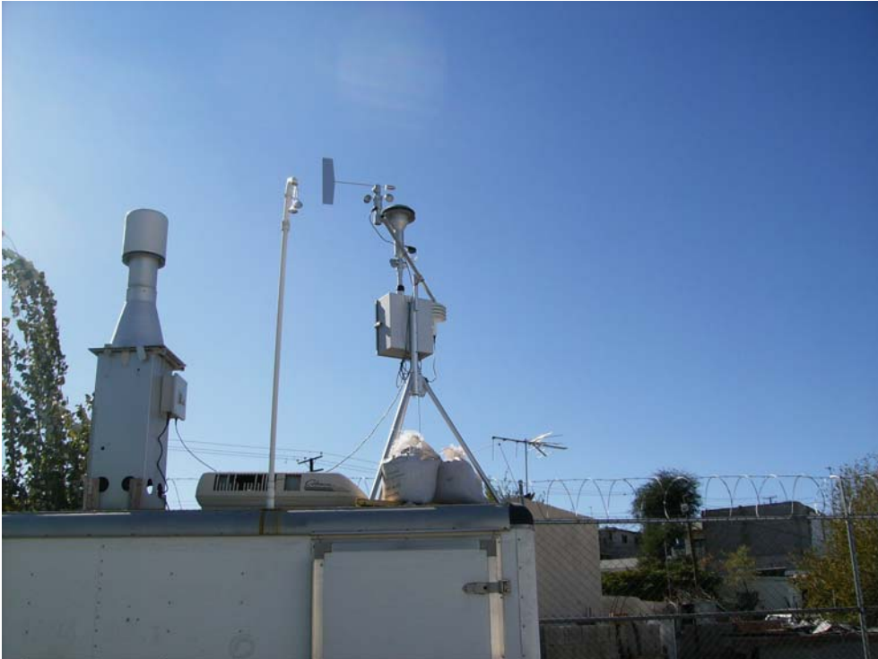
Foto 2. Sitio 19, Monitor instalado en Estación ACS.
